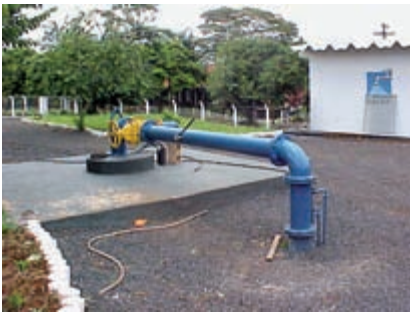
Ribeirão Preto (SP) – Poço tubular corretamente construído e protegido. Foto: Arquivo IG/SMA.
